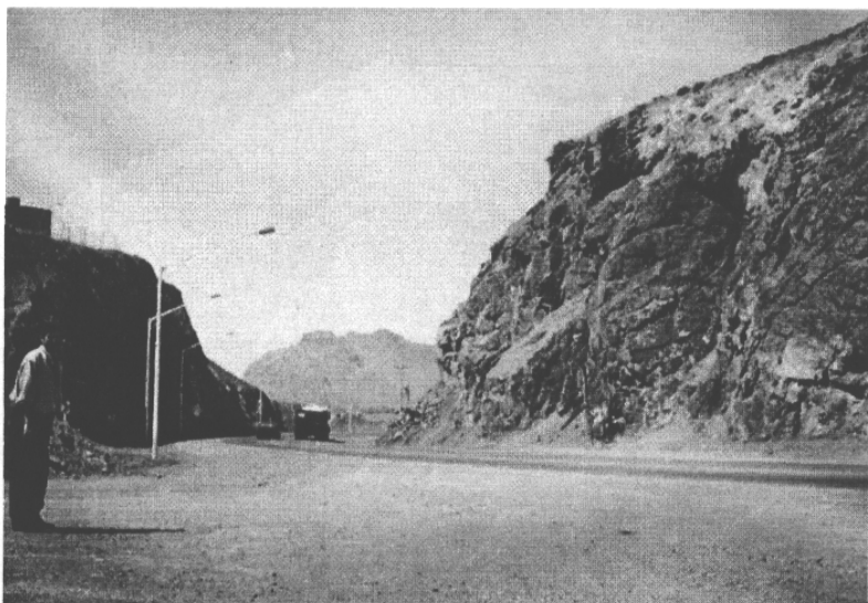
شکل شماره ۲۳. تصویر پیچ ورودی به روستای صلوات آباد و احتمال ریزش دیواره‌ی کنار آن به دلیل هوازدگی مکانیکی
